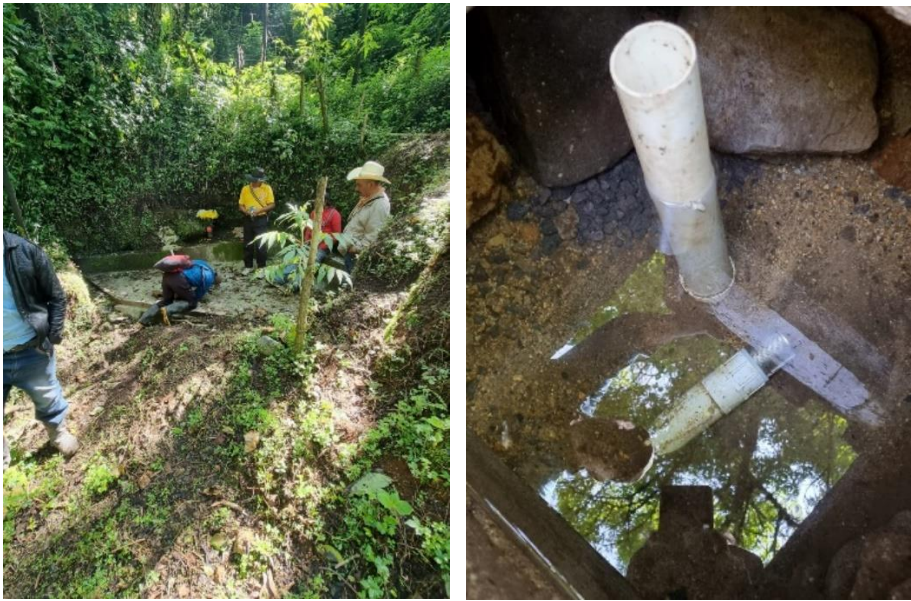
Fuente: Visita técnica 12/05/2021
