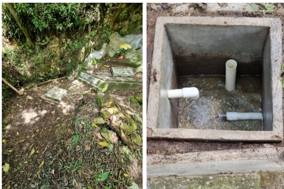
Fuente: Visita técnica 12/05/2021
