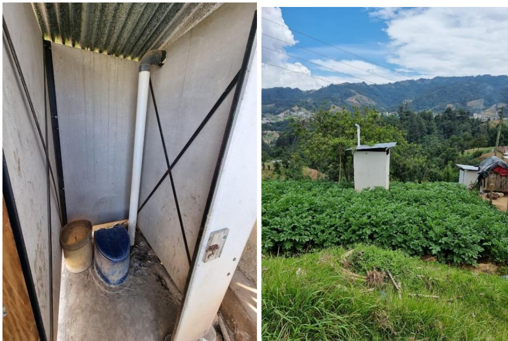
Fotografía 27. Letrinas de pozo seco.
