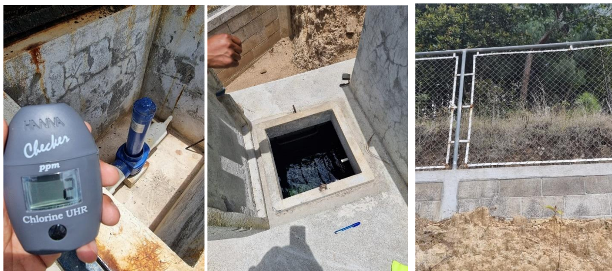
Fotografía 13. Infraestructura tanque de distribución.
