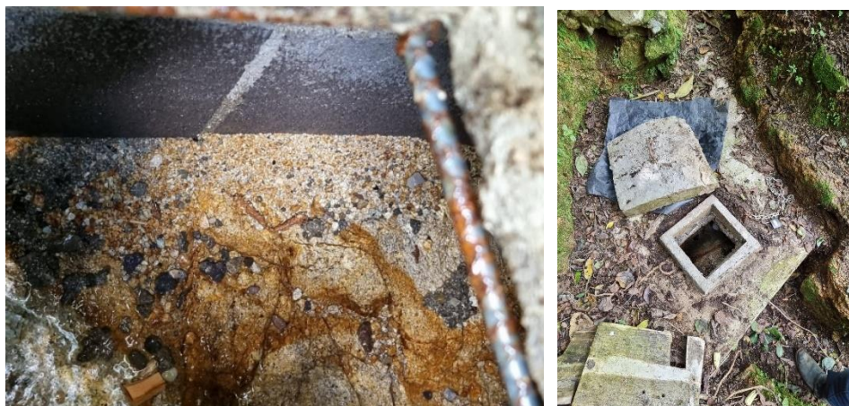
Fuente: Visita técnica 12/05/2021
