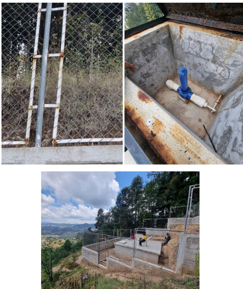
Fotografía 24. Sistema de desinfección.
