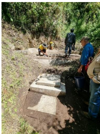
Fuente: Visita técnica 12/05/2021
