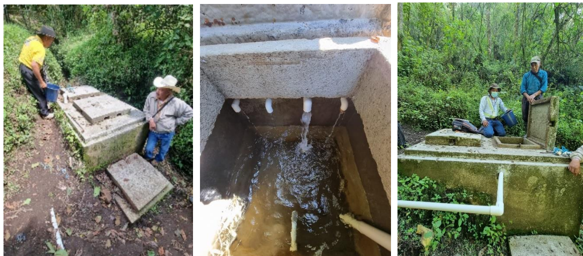
Fuente: Visita técnica 12/05/2021
