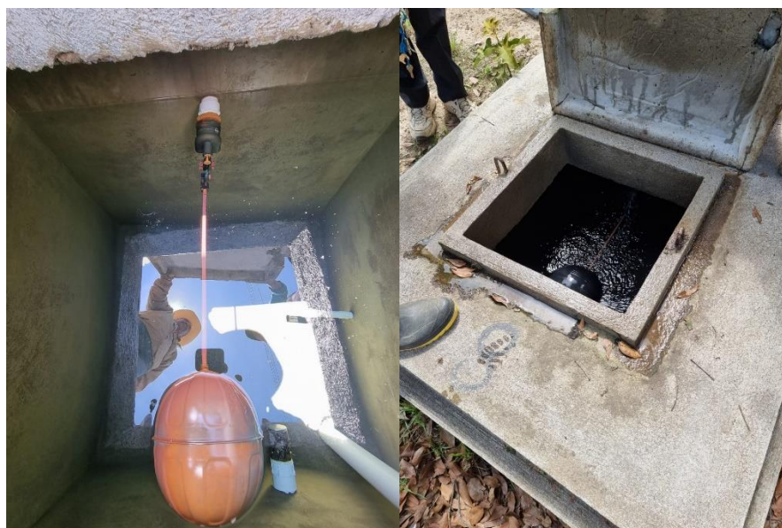
Fotografía 25. Cajas rompe presión en distribución.
