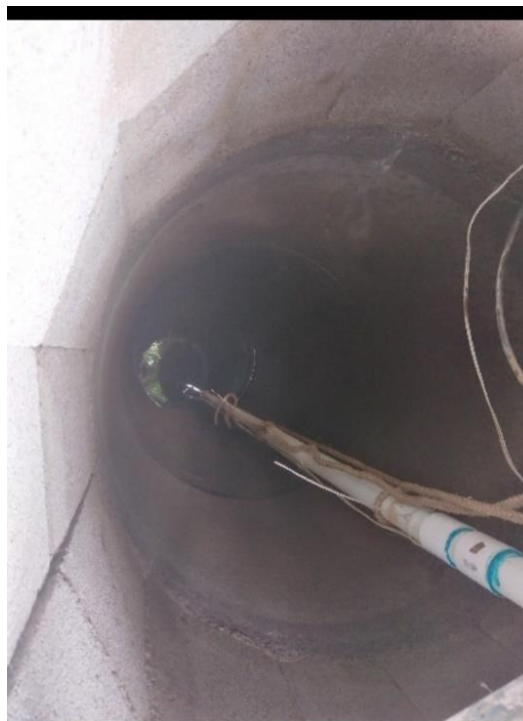
Figura 3 Pozo del sistema
