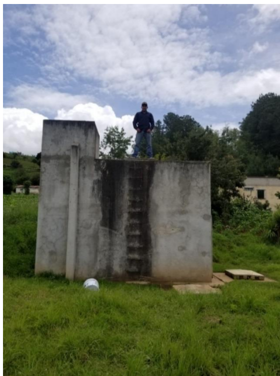
Figura 4 Tanque de almacenamiento
