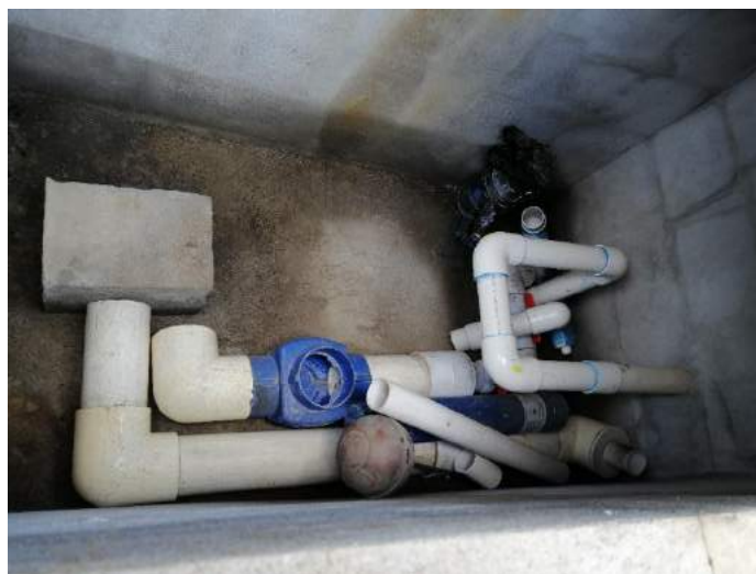
Fotografía 6 Sistema de desinfección, no está en funcionamiento.
