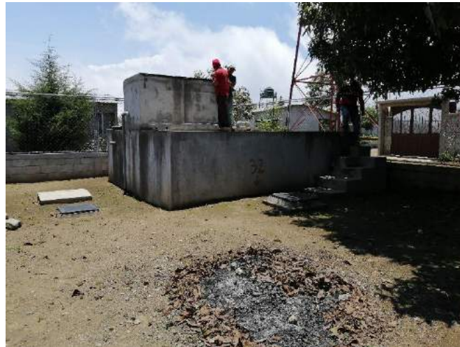
Fotografía 5 Tanque de distribución del sistema de Pahaj, Fuente de Vida
