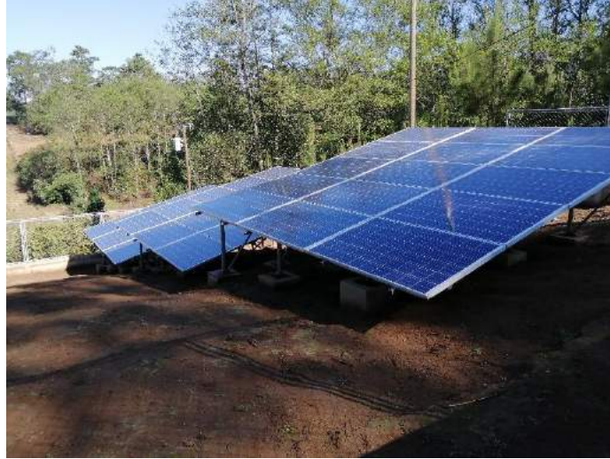
Fotografía 4 Banco de paneles solares del sistema de agua, Fuente de Vida
