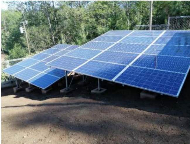
Fotografía 8 Banco de Paneles Solares
