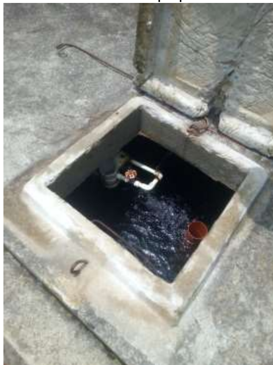
Fotografía 3. Clorinador Elaboración propia.
