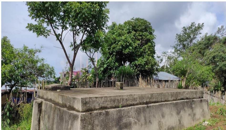
Ilustración 5: Fotografía de riesgo inexistencia sistema de desinfección.
