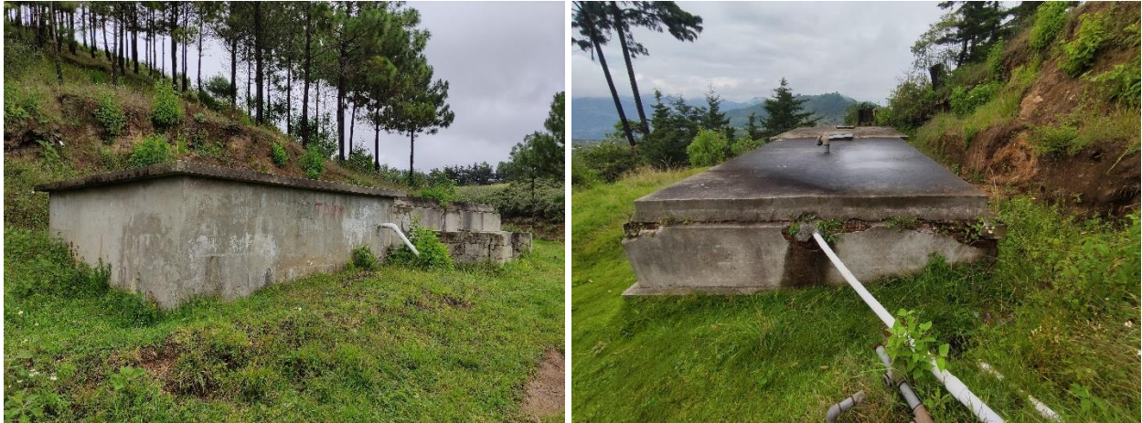
Ilustración 7: Fotografía de los tanques de distribución
