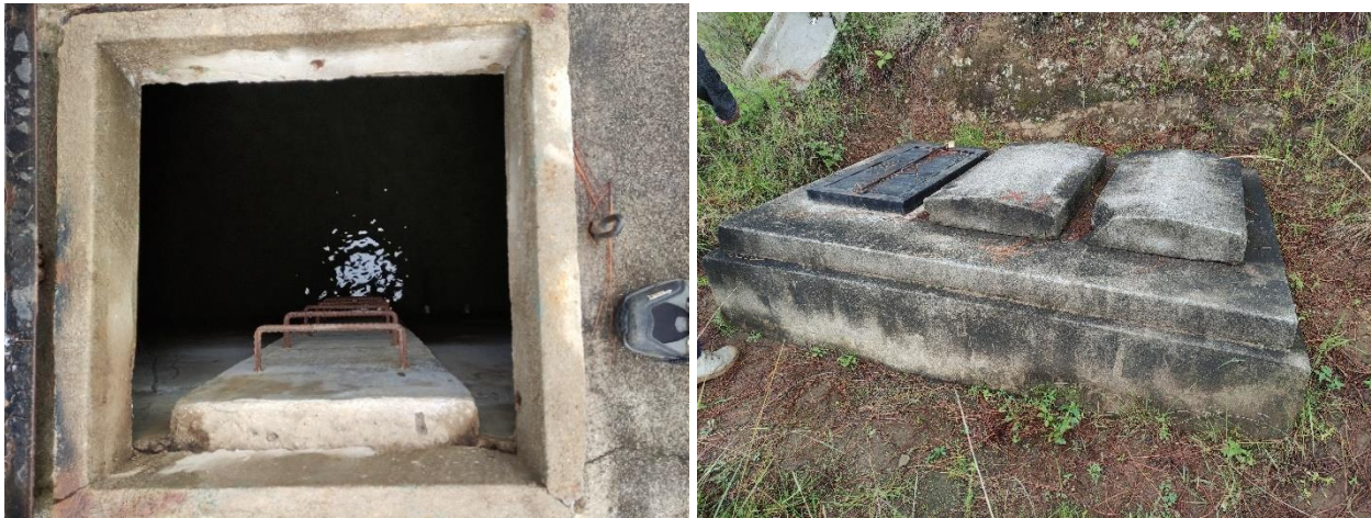
Ilustración 8: Fotografías del interior de la cámara del tanque de distribución y caja distribuidora de caudales
