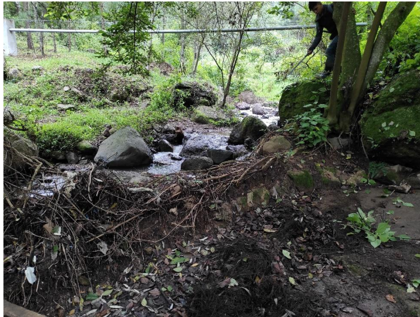
Ilustración 3: Fotografía de riesgo en la captación.
