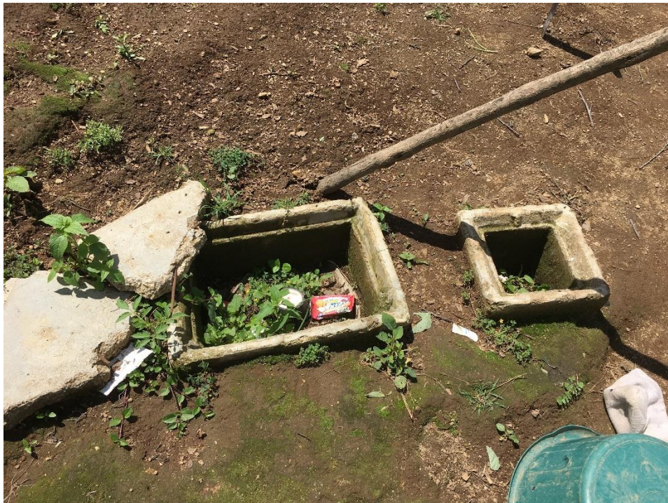
Ilustración 13: Fotografía Estado de micromedidor (conexión domiciliar)
