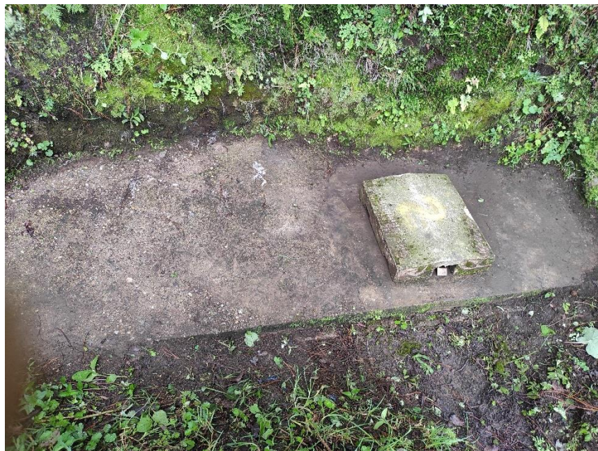
Ilustración 5: Fotografía de riesgo en la captación 2.
