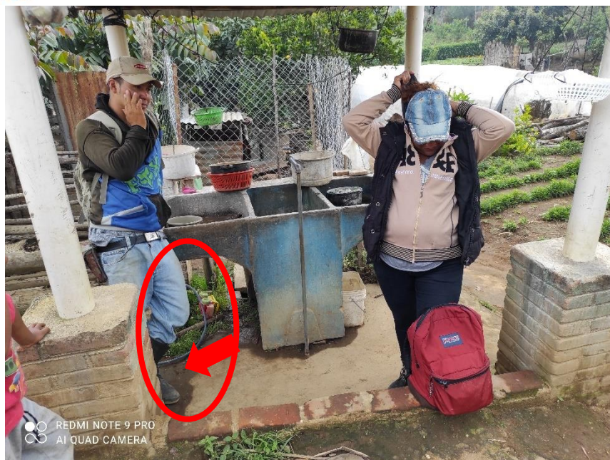
Ilustración 10: Fotografía de pila y desfogue de aguas grises a flor de tierra.
