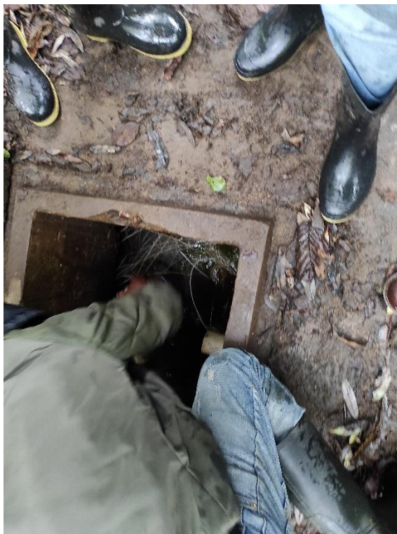
Ilustración 7: Fotografía del estado actual de las válvulas de limpieza.
