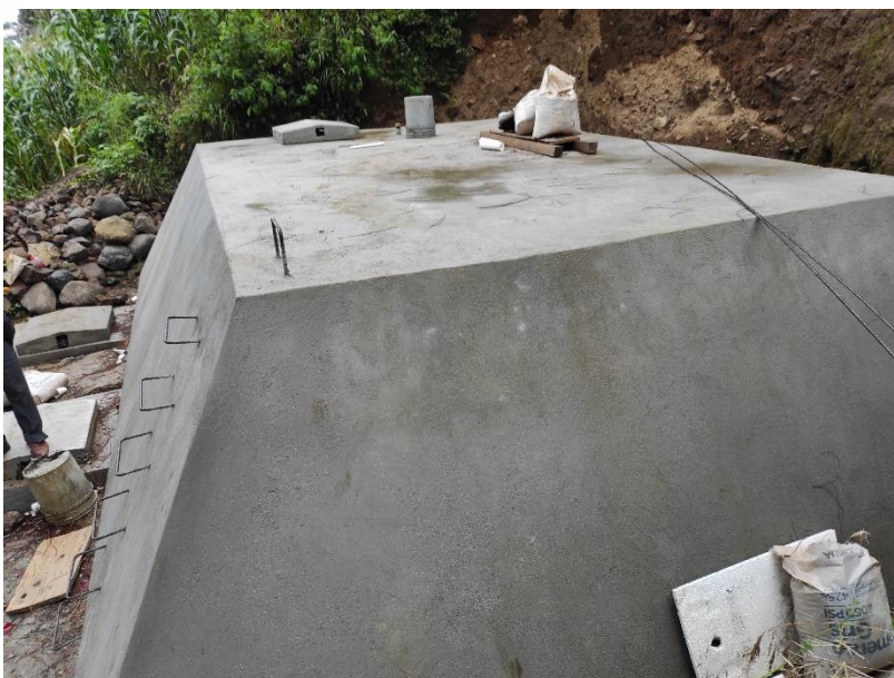
Fotografía 4 de riesgo inexistencia sistema de desinfección.
