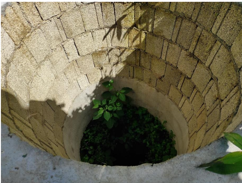
Fotografía 2 riesgo pozo sin uso.
