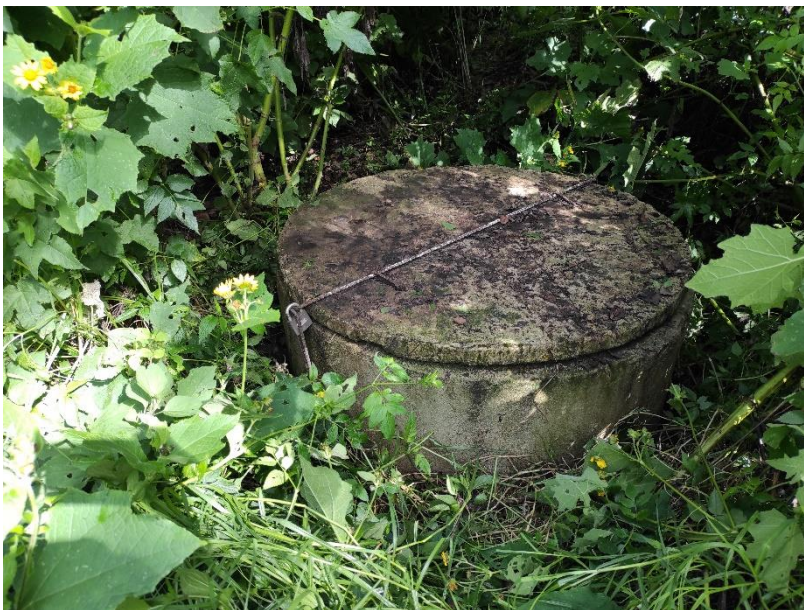
Fotografía 1 de riesgo pozo principal
