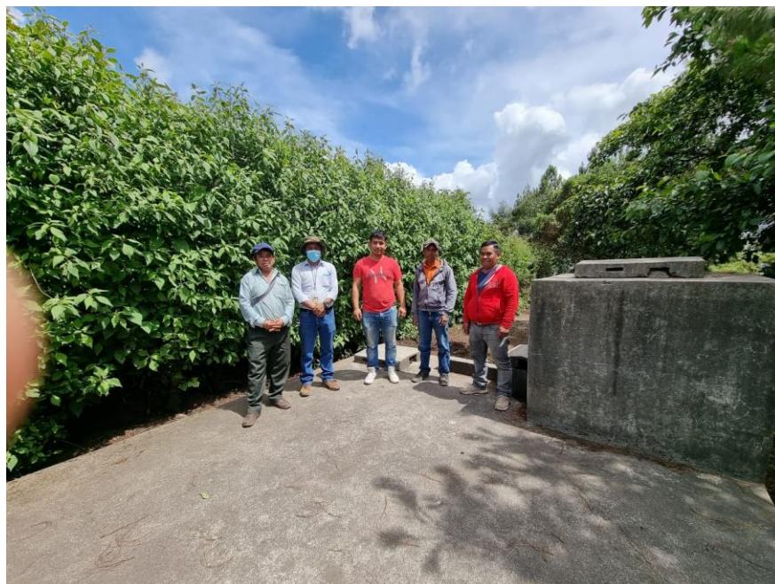
Fotografía 8. Ausencia de sistema de desinfección.
