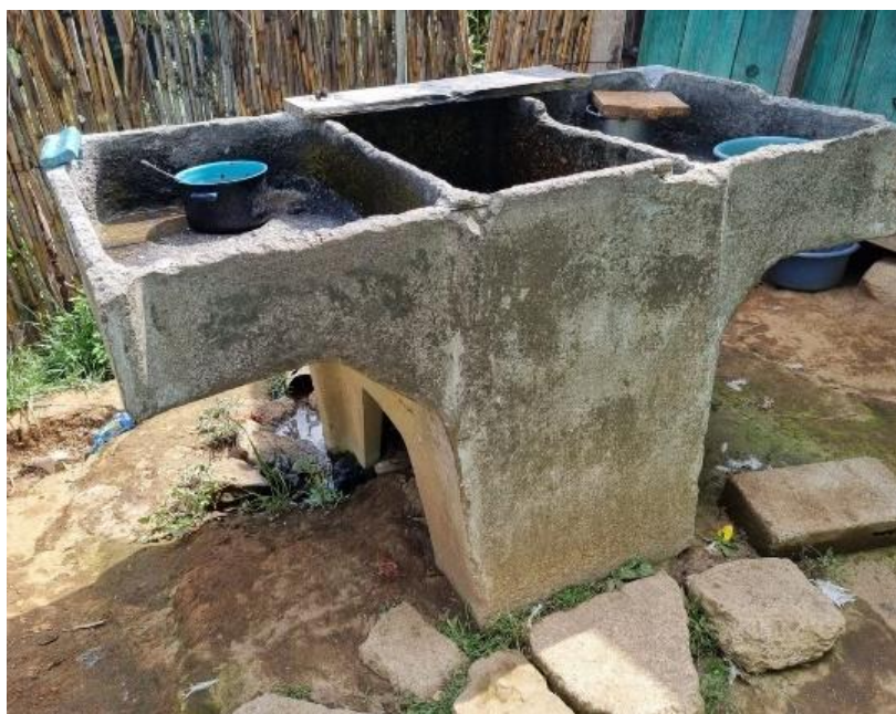
Fotografía 13. Disposición de aguas grises a flor de tierra.
