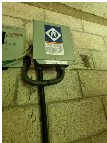
Fotografía 14. Bomba sumergible, y panel de control
