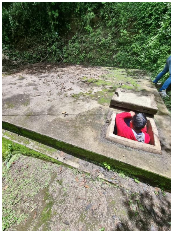
Fotografía 7. Riesgo actual en tanque de bombeo.
