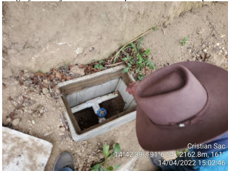
Fotografía 3 Caja válvula de limpieza 2 San José Xiquinabaj
