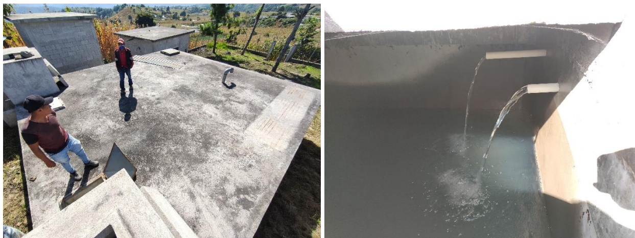
Ilustración 9: Fotografía del tanque de distribución
