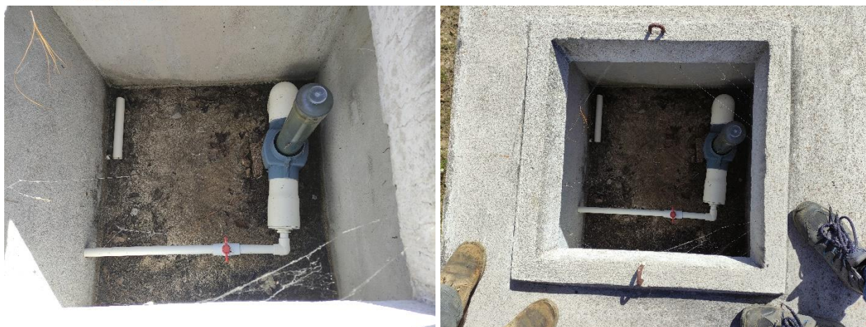
Ilustración 8: Fotografía del termo de clorador, instalado en el tanque de distribución (sin funcionamiento)
