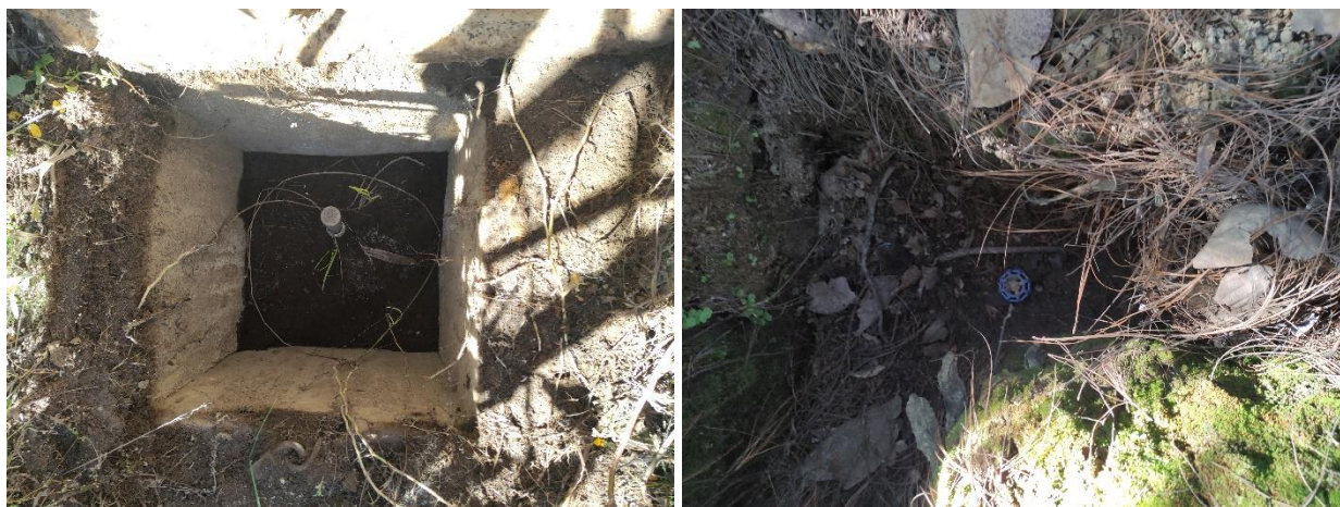
Ilustración 7: Fotografías de las válvulas de aire y limpieza
