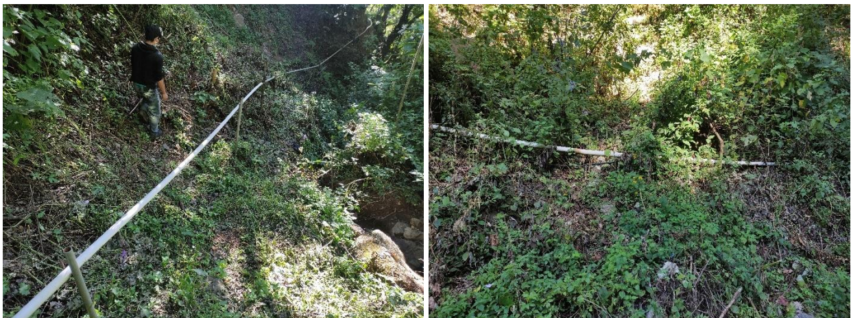
Ilustración 5: Fotografías de tubería expuesta
