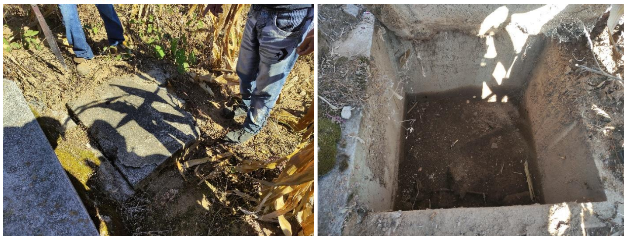
Ilustración 6: Fotografías de la caja de válvula de aire
