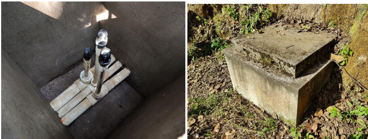
Ilustración 8: Fotografías de las válvulas de aire + caja de concreto
