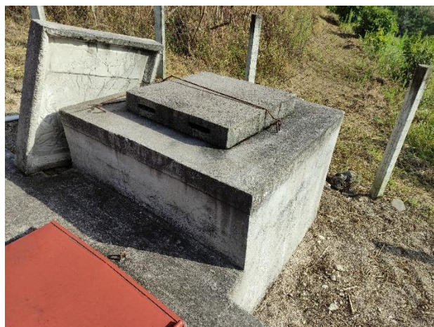
Ilustración 9: Fotografía de la caja de concreto + el termo del clorador (sin funcionamiento)
