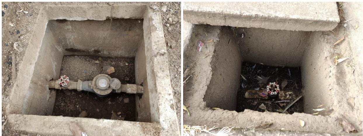
Ilustración 12: Fotografías del macro medidor y llave de paso
