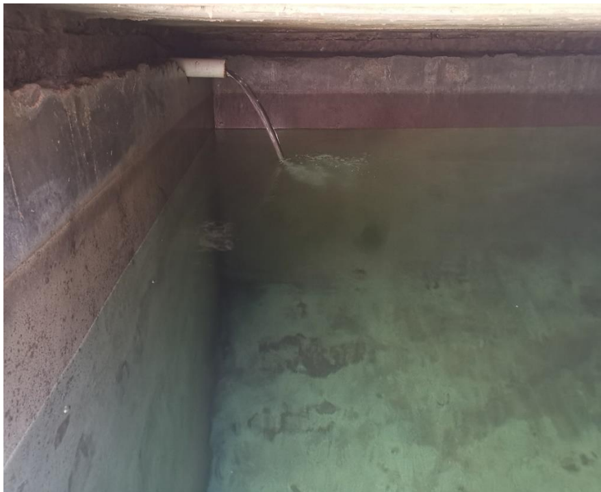
Fotografía 3: Vista de la falta de desinfección del sistema de agua.
