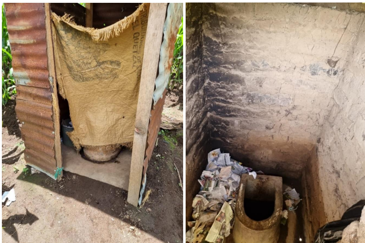
Fotografía 15. Letrinas de pozo seco.
