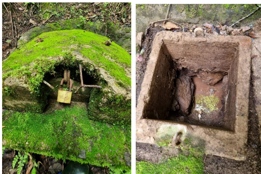
Fotografía 8. Riesgo actual en la fuente No. 1.
