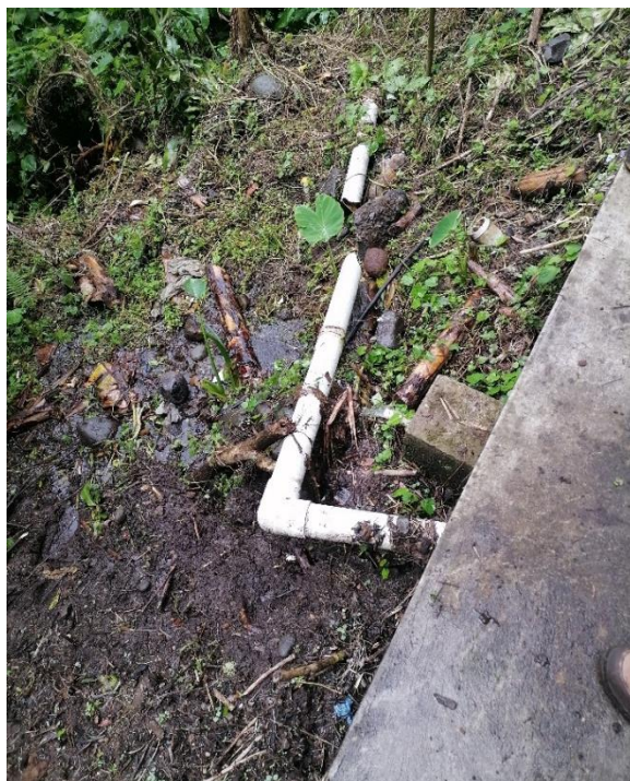
Fotografía 4. Tubería no conectada y expuesta.
