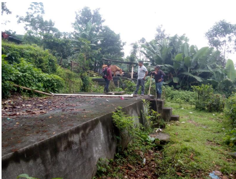
Fotografía 7. Tanque de distribución sin cerco perimetral.
