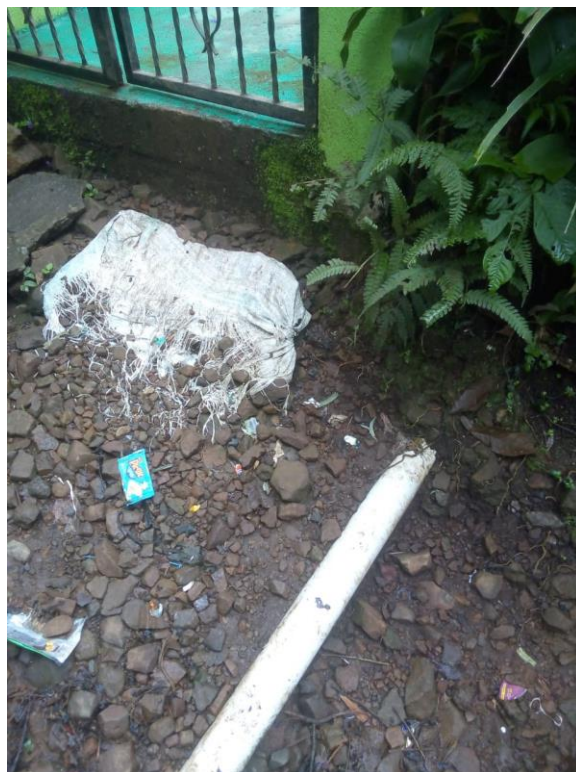
Fotografía 6. Tuberías de conducción expuestas
