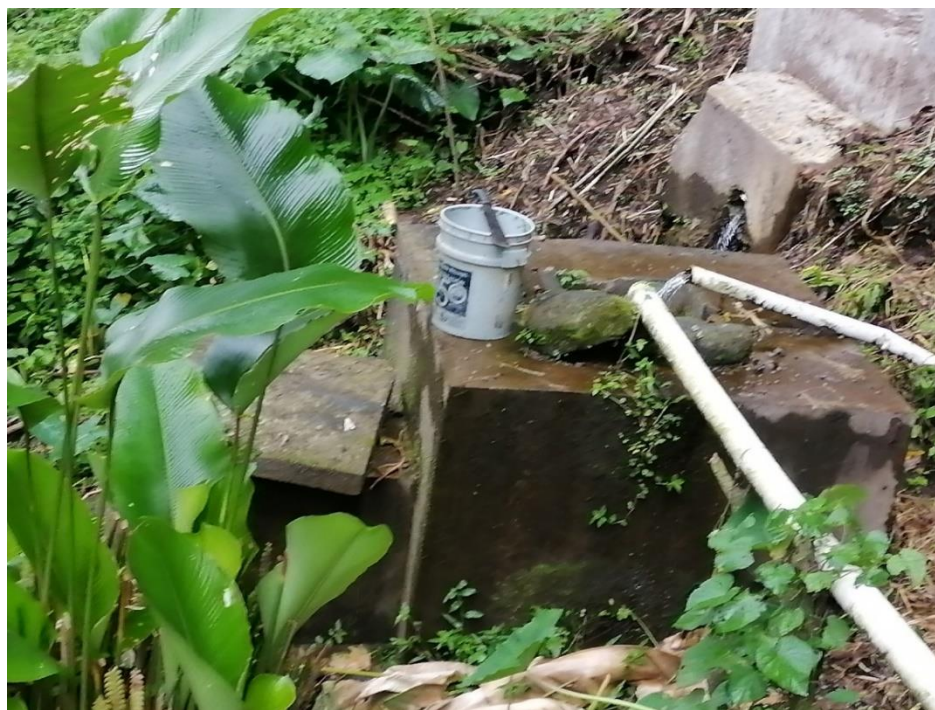
Fotografía 3. Conexiones en caja reunidora mal instaladas
