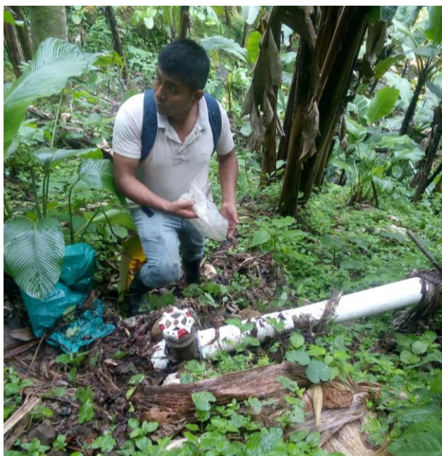
Fotografía 5. Válvula expuesta sin caja.
