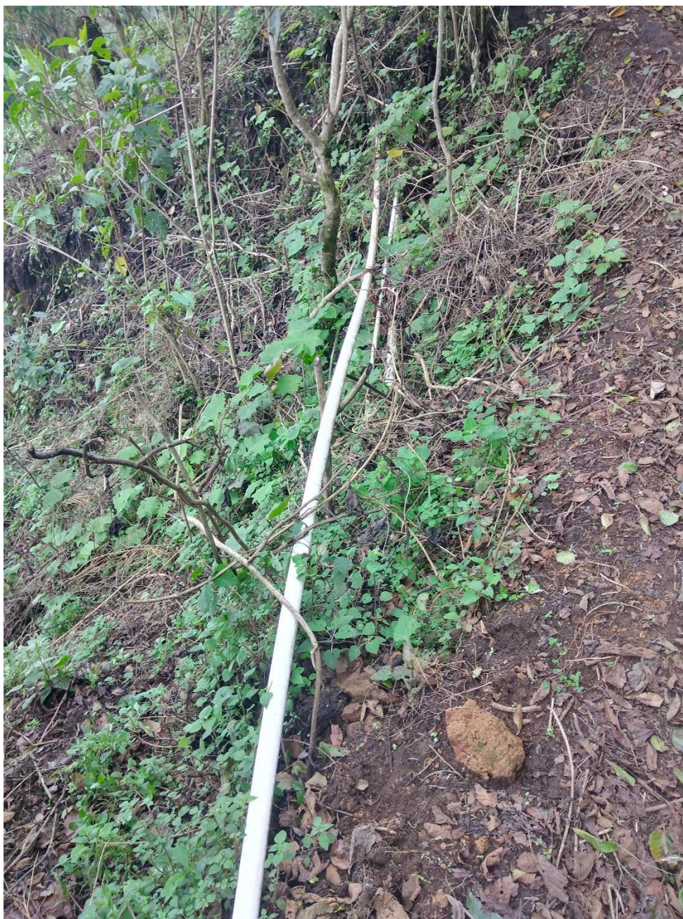
Fotografía 3. Tubería expuesta en algunos tramos de conducción. Elaboración propia.
