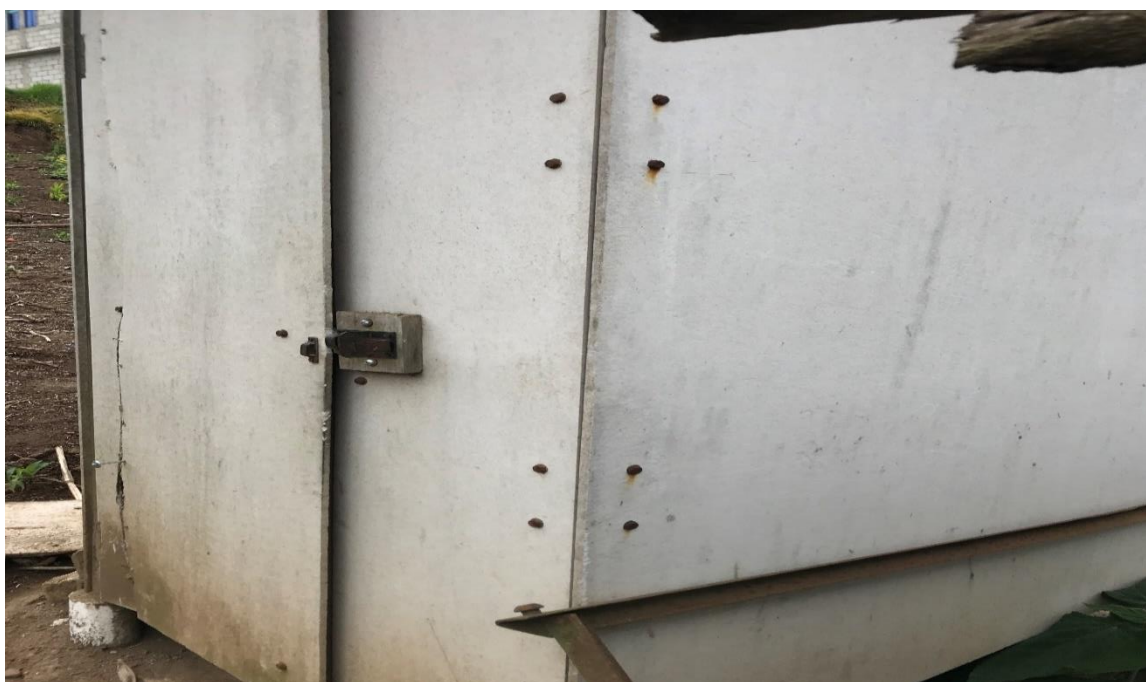
Ilustración 6. Se Ilustración representa la disposición final de excretas, mediante letrinas de hoyo seco ventilado.
