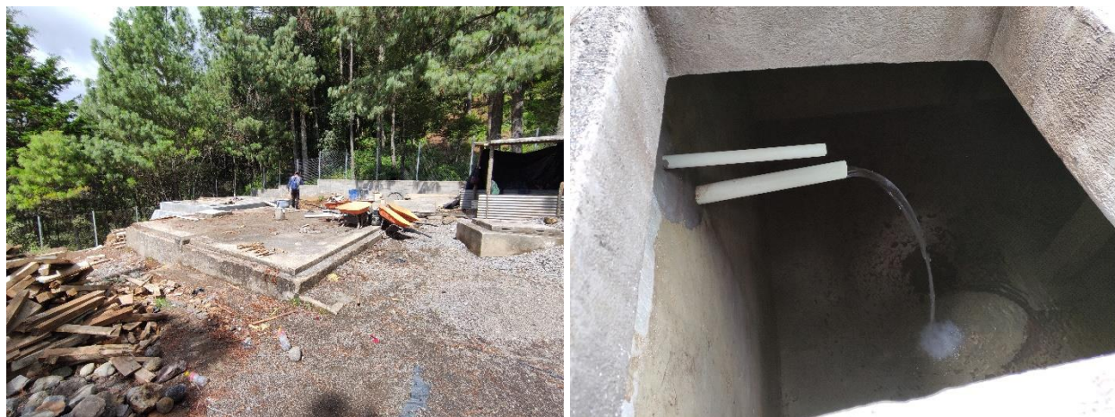
Ilustración 8: Fotografía del tanque de distribución
