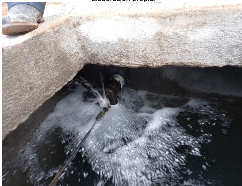
Fotografía 5. Válvula de flote en mal estado. Elaboración propia.
