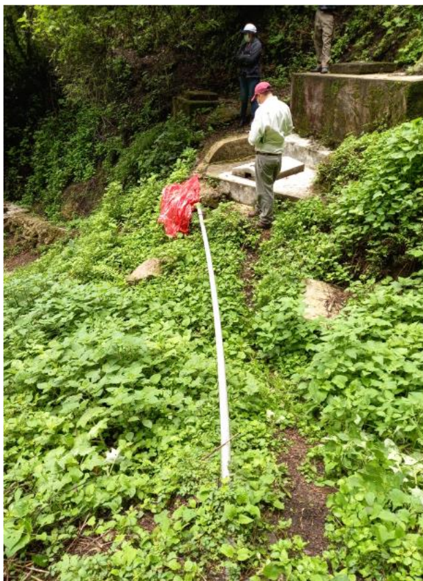
Fotografía 2. Tubería PVC expuesta a sol y rotura. Elaboración propia.
