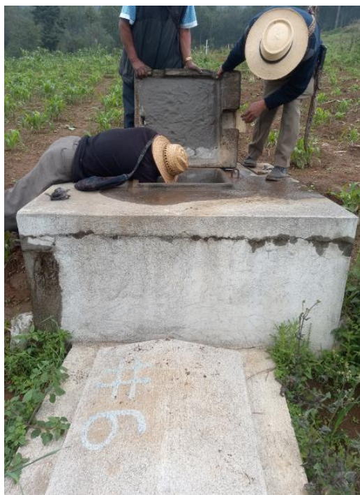
Fotografía 4. Caja rompe presión (embalse) con filtraciones. Elaboración propia.
