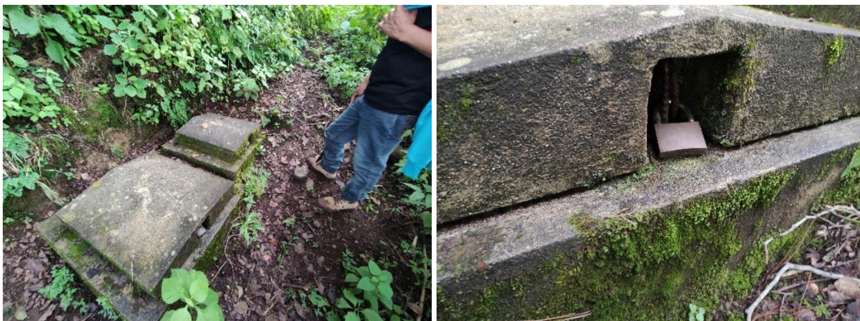
Ilustración 7: Fotografías de la caja de concreto + válvula de aire
