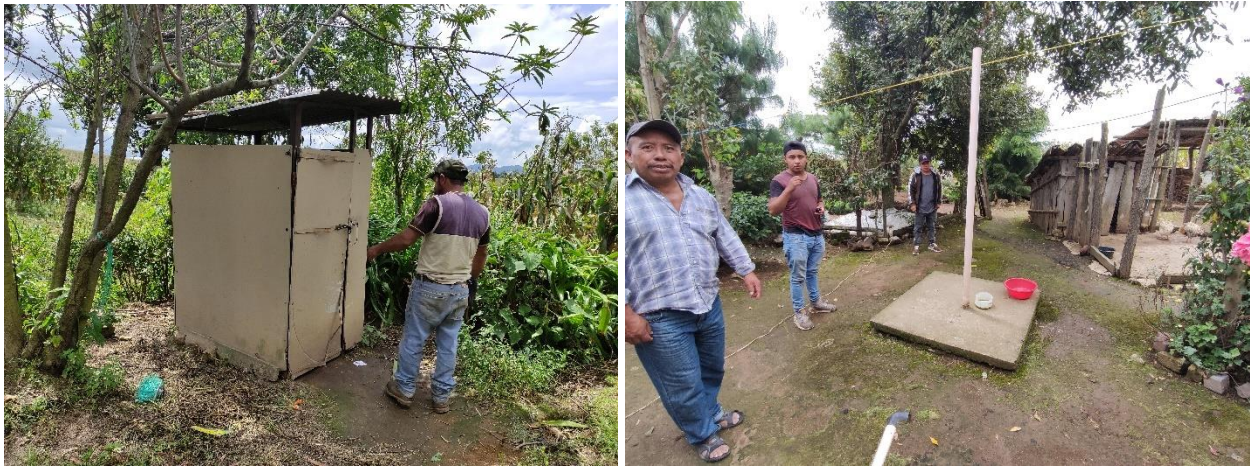
Ilustración 12: Fotografías del estado actual del saneamiento
