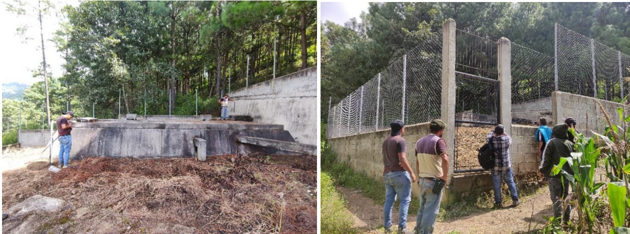
Ilustración 10: Fotografía del predio de los tanques de distribución
