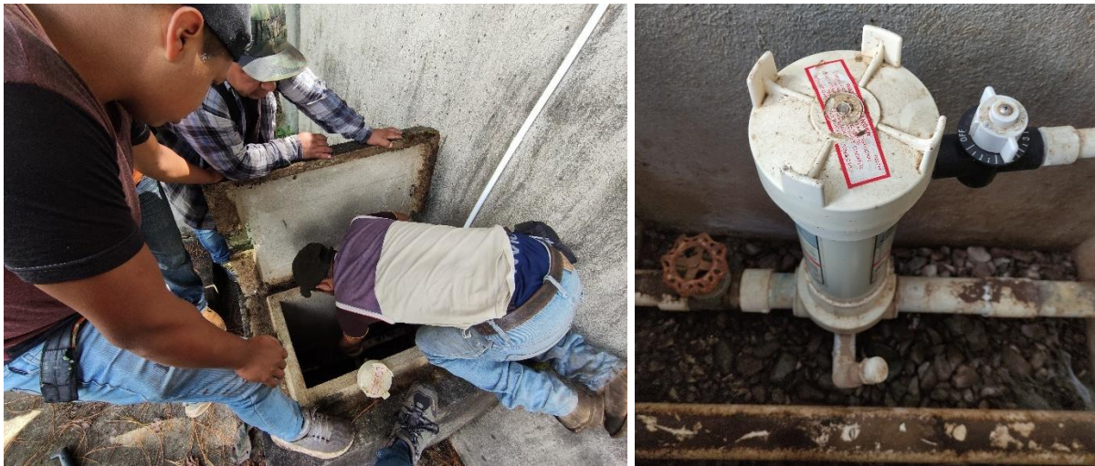
Ilustración 8: Fotografía del termo de clorador, instalado en el tanque de distribución (sin funcionamiento)
