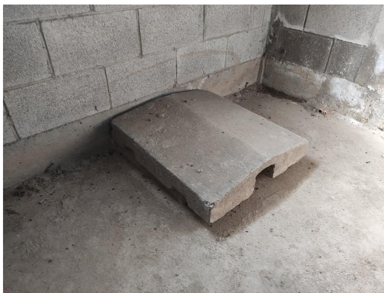
Ilustración 12: Caseta de bombeo
