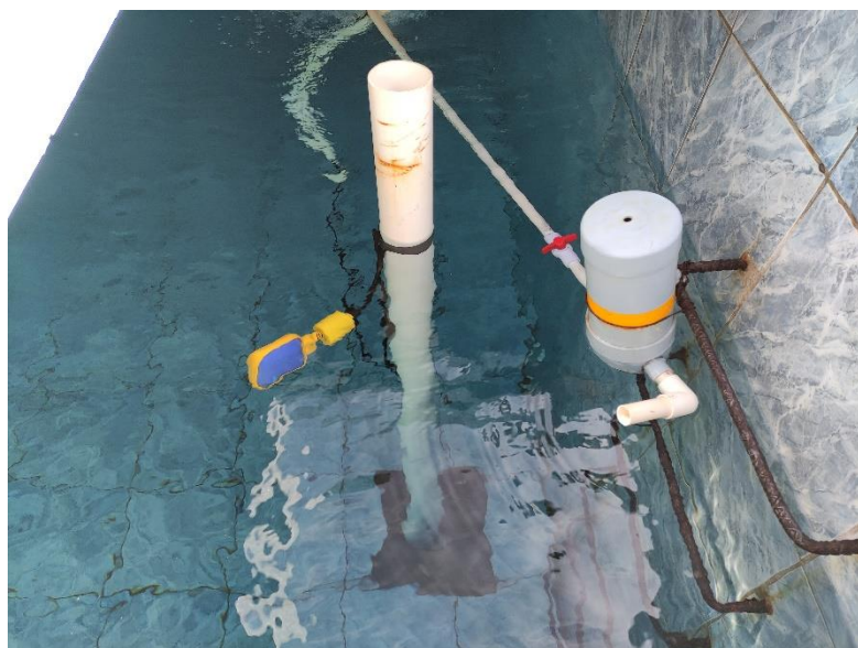
Ilustración 4: Fotografía del termo de clorador, instalado en el tanque de distribución (sin funcionamiento)
