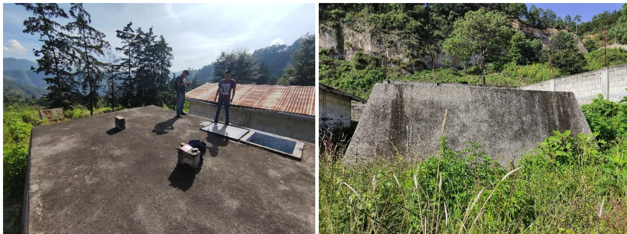
Ilustración 5: Fotografía de los tanques de distribución
