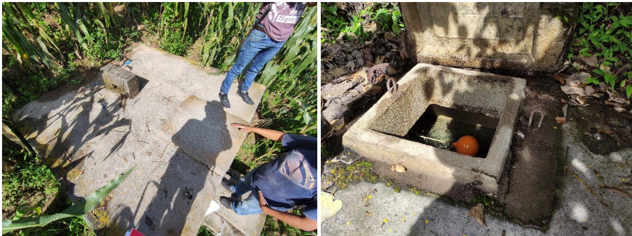
Ilustración 7: Fotografías del tanque de almacenamiento y caja rompe presión con válvula de flote
