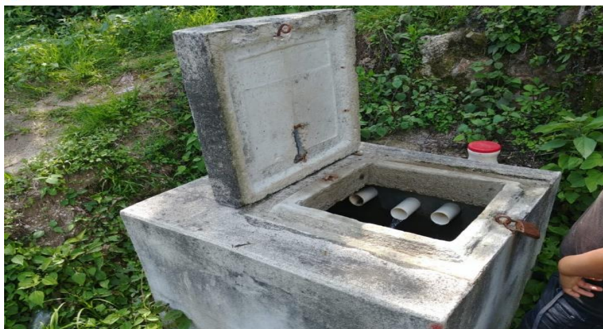
Ilustración 6. Captación de agua de la fuente que abastece a Caserío Tierra Linda,
