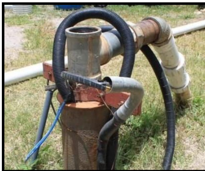
Ilustración 4. Vista pozo mecánico El Estadio
