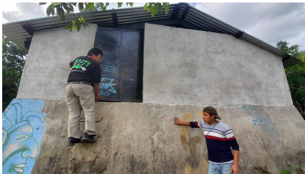
Fotografía 12 Filtro de grava principal
