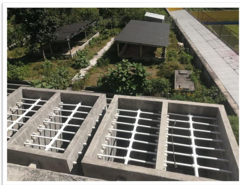
Fotografía 22 Planta de tratamiento de aguas residuales, sin funcionamiento
