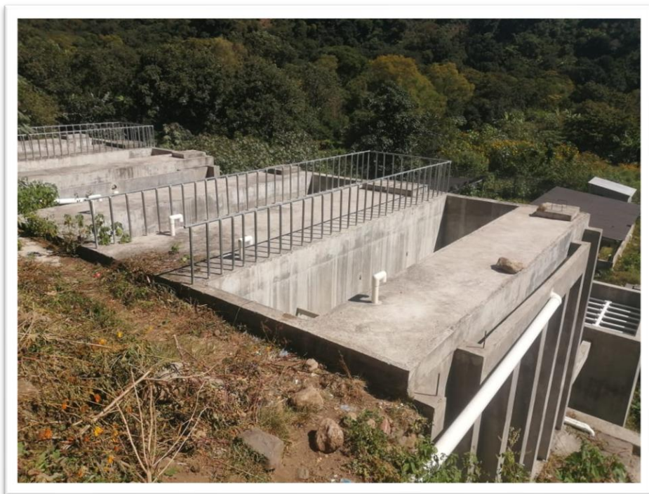
Fotografía 24 Planta de tratamiento de aguas residuales, sin funcionamiento 2
