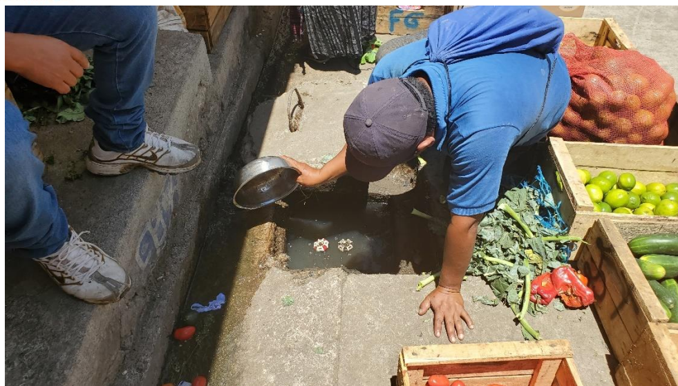
Fotografía 17 Cajas de válvulas de operación red de distribución
