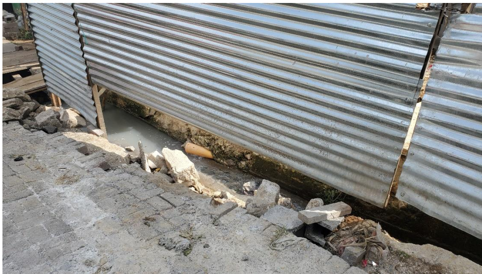
Fotografía 21 Cuneta para el transporte de aguas grises
