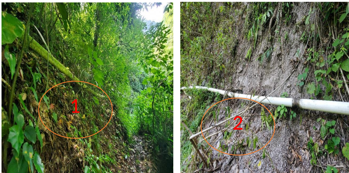
Fotografía 10 Línea de conducción San Pablo la Laguna
