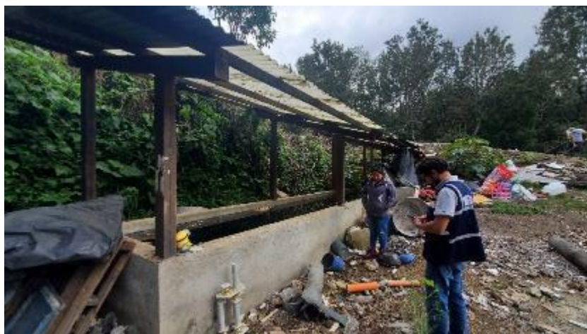
Fotografía 56 Pila de Lixiviados
