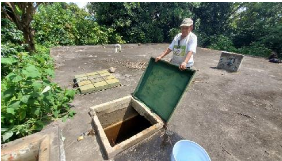
Fotografía 24 Tanque de almacenamiento 1 (1)
