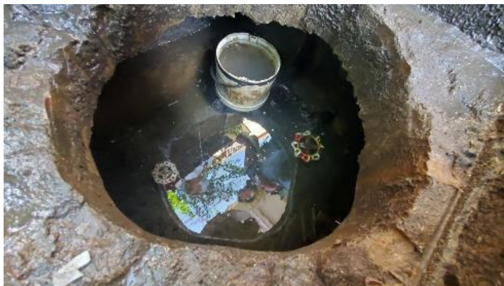
Fotografía 35 Cajas de válvulas de operación red de distribución 1
