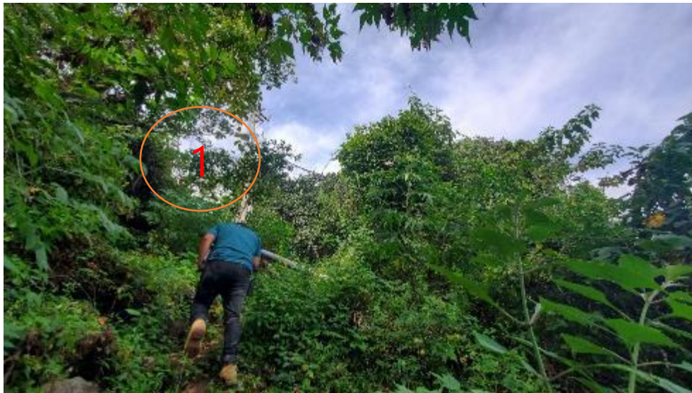
Fotografía 9 Poste de conexión eléctrica "Orilla del Lago"
