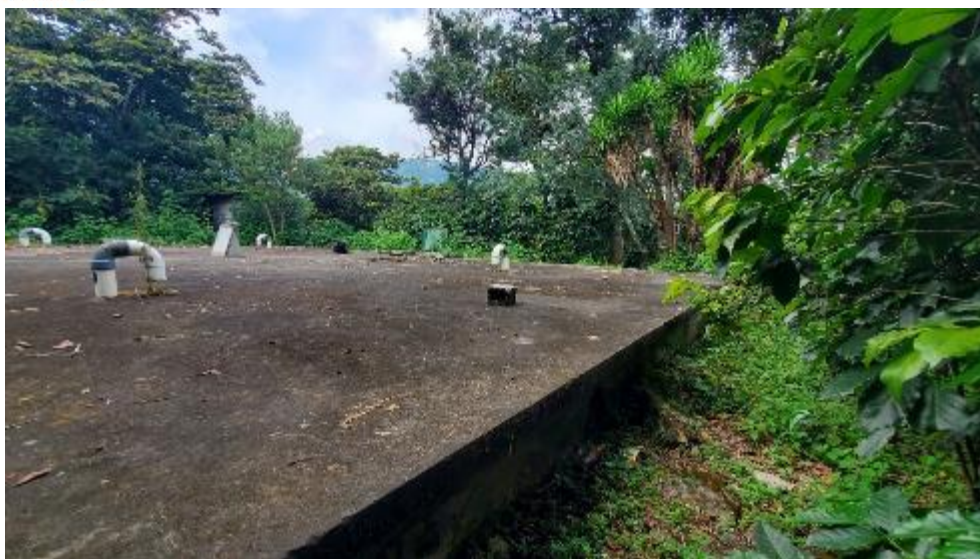
Fotografía 23 Tanque de almacenamiento 1
