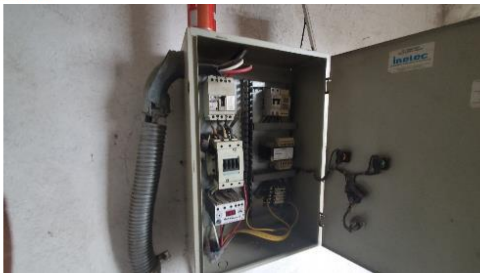
Fotografía 3 Panel de Control sistema "La Calzada"
