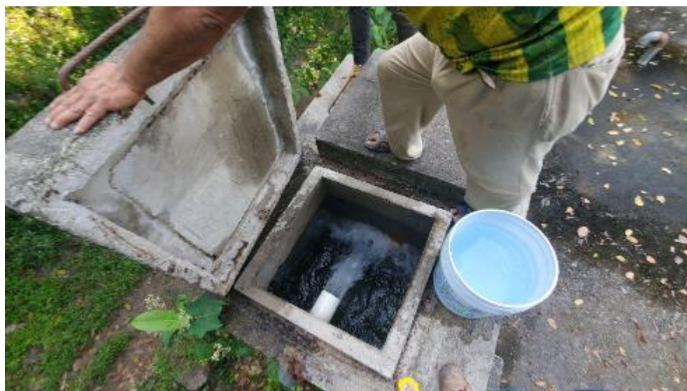
Fotografía 28 Tanque de almacenamiento 3 (1)
