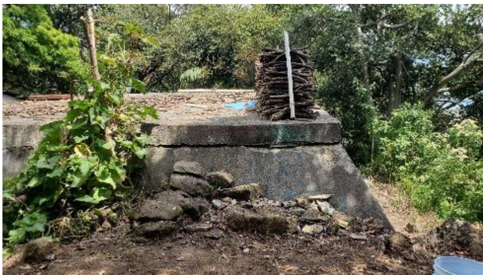
Fotografía 26 Tanque de almacenamiento 2 (1)
