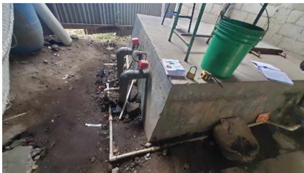
Fotografía 30 Tanque de distribución (1)
