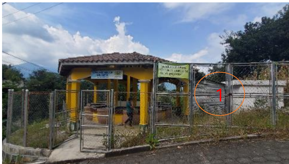
Fotografía 16 Ubicación pozo mecánico "Pasaqman"
