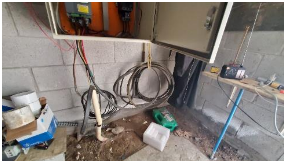
Fotografía 13 interior de caseta de control "Pacucha"
