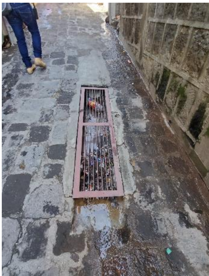
Fotografía 50 Rejillas para sistema de drenaje Pluvial calzada principal con desechos
