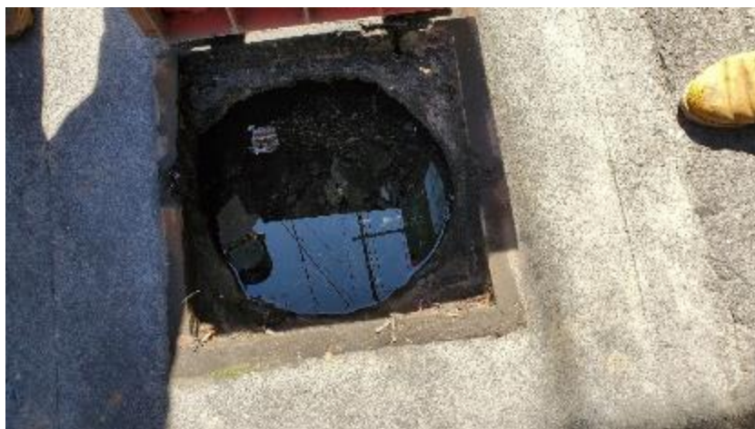
Fotografía 36 Cajas de válvulas de operación red de distribución 2
