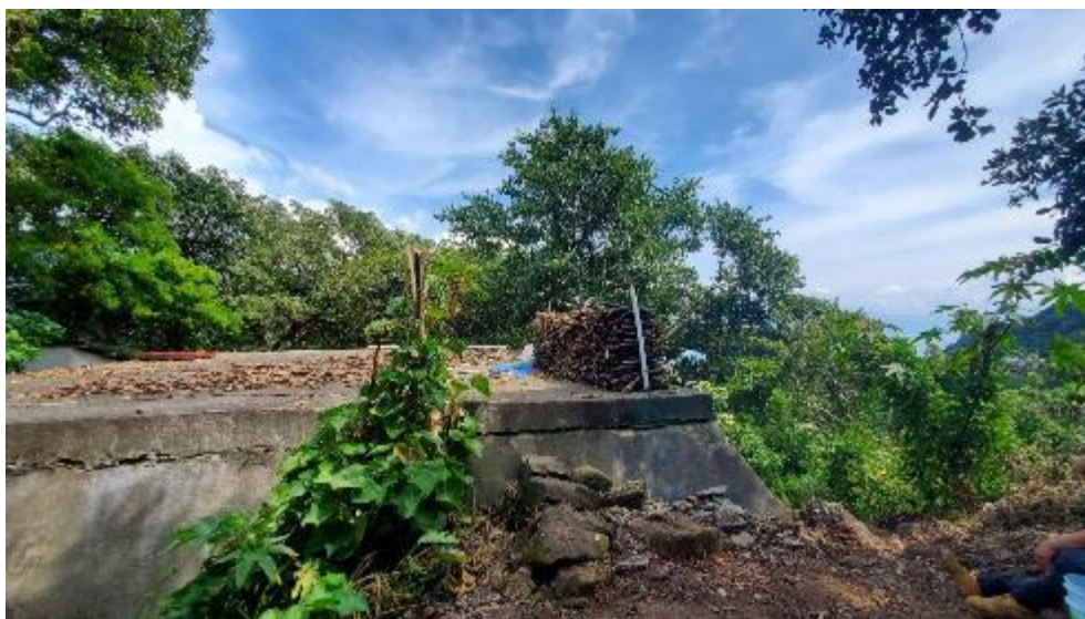
Fotografía 25 Tanque de almacenamiento 2
