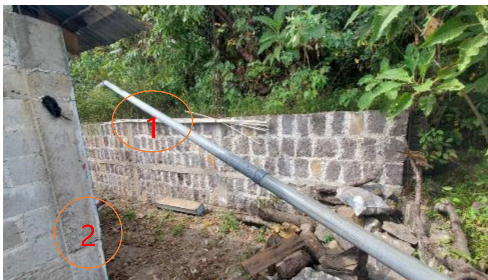
Fotografía 20 Línea de conducción
