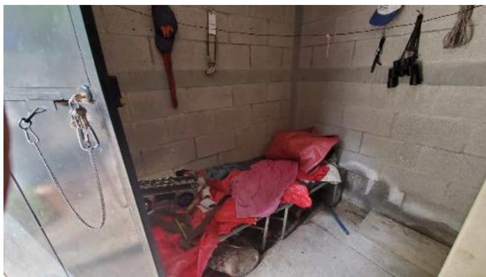
Fotografía 15 interior de caseta de control "Pacucha" 1,
