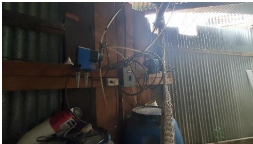
Fotografía 33 Conexión eléctrica sistema de desinfección
