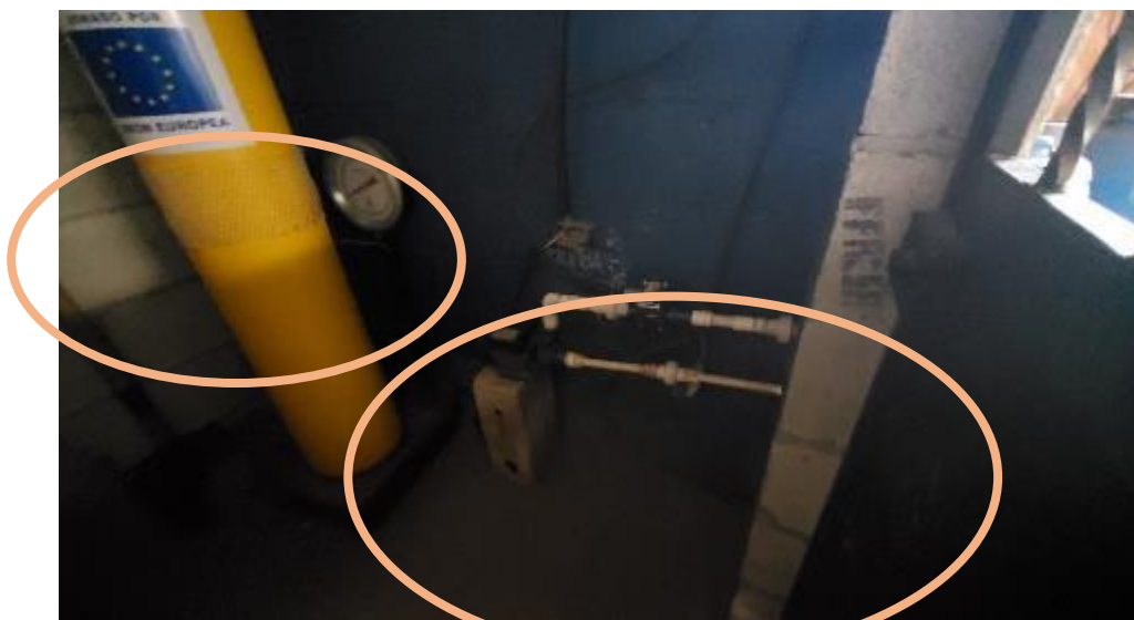
Fotografía 32 Bomba dosificadora de gas cloro
