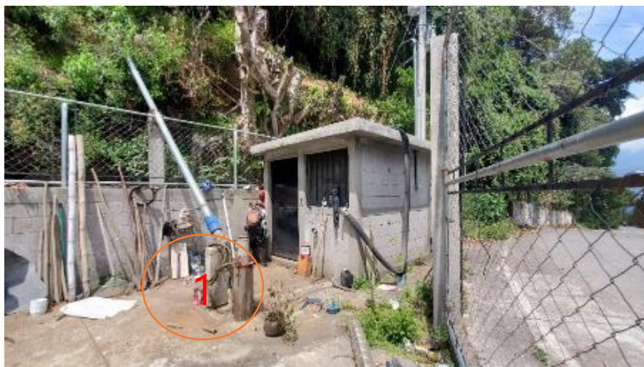
Fotografía 11 Pozo mecánico "Pacucha"
