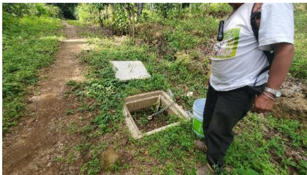
Fotografía 34 Cajas de válvulas de operación red de distribución
