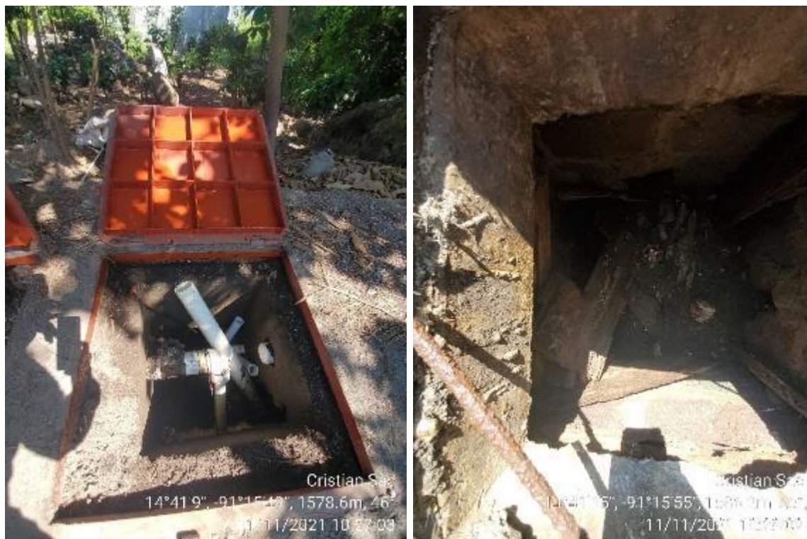
Fotografía 39 Cajas de válvulas de operación red de distribución 3
