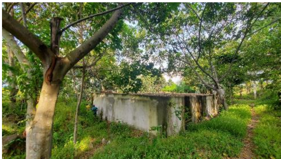
Fotografía 27 Tanque de almacenamiento 3
