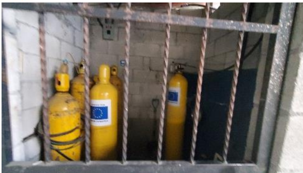
Fotografía 31 Cilindros de gas cloro, sistema de desinfección
