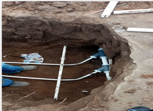
Sistema de conducción de agua domiciliar. Fuente, Municipalidad de Magdalena Milpas Altas
