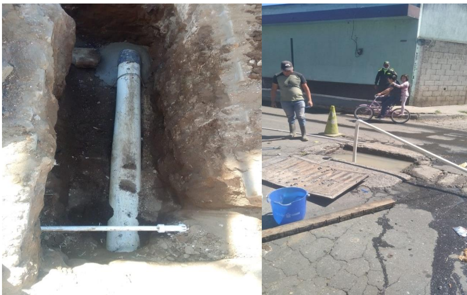
Imagen No. 1 Sistema de agua, casco urbano Zaragoza 2022
